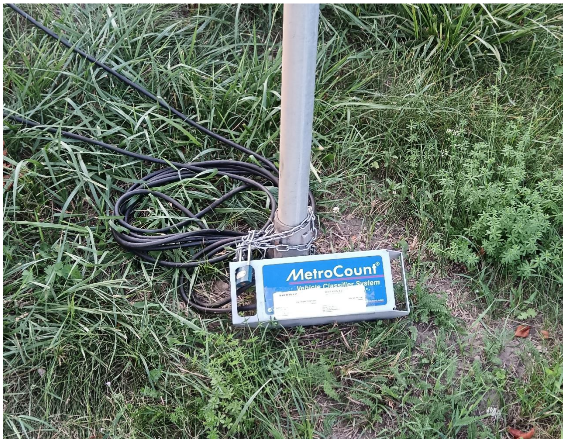
Obrázek 13: instalovaná měřicí jednotka.
